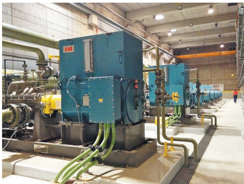
Насосная станция ГАЗС Эль-Иерро
