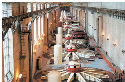
Машинный зал Жигулёвской ГЭС, построенной на Волге в Самарской области. Раньше эта станция носила название Волжская ГЭС им. Ленина
