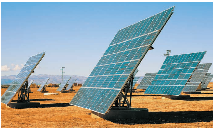
Солнечная батарея — главный элемент большинства СЭС. Она преобразует солнечный свет в электроэнергию. Правда, пока средний КПД таких устройств невелик — 10–12%
