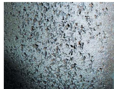
Поверхность металла, изъеденная «холодным кипением»
