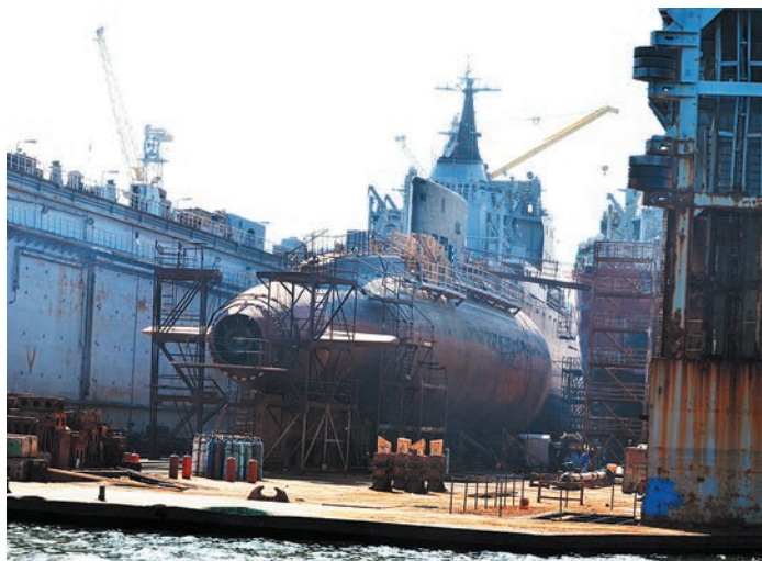
Подводная лодка «Алроса» из ремонта в доке переходит в ремонт на плаву, а затем вновь ремонтируется в доке. И так уже 20 лет
